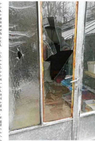
Die Tür zur Igelstation wurde eingeschlagen. Direkt dahinter befindet sich der erste Käfig mit einem Igel. Dieser wurde aber durch die Glasscherben nicht verletzt.
